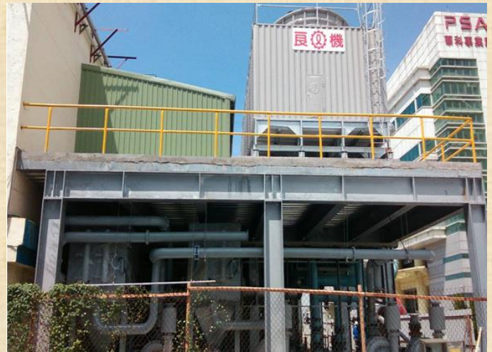
志昱科技電器室冷卻水塔
